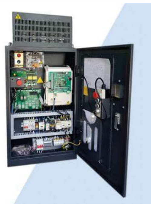
Tủ điều khiển Vi xử lý ( Thailand)
